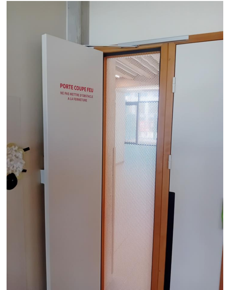
Exemple de porte de transfertsur couloir pour sur-ventilation nocturne Ecole Eugénie Brazier - Lyon
